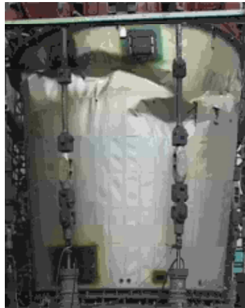
Рис. 9. Разрушение МСО 2-3 ступеней
